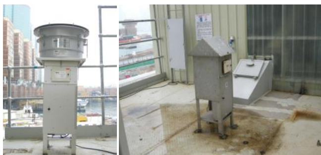
安裝在廠房的空氣監測儀器監察總懸浮粒子和可吸入懸浮粒子量，以確保符合空氣質量標準，並為評估四周感應強接收者的塵埃暴露值提供有用數據
